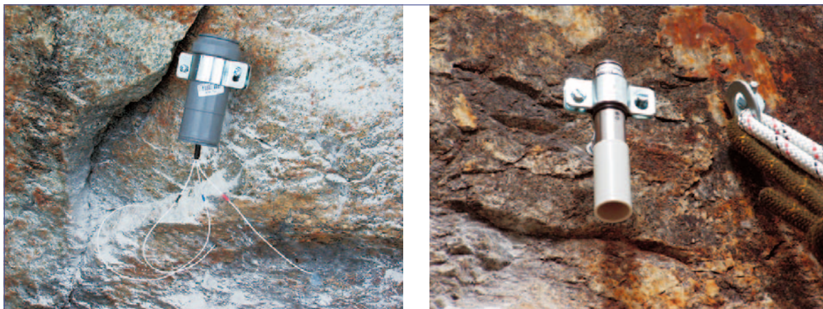
Figura 7 Sensori attualmente installati presso il sito della Capanna Carrel (a sinistra temperatura roccia, a destra temperatura aria)
