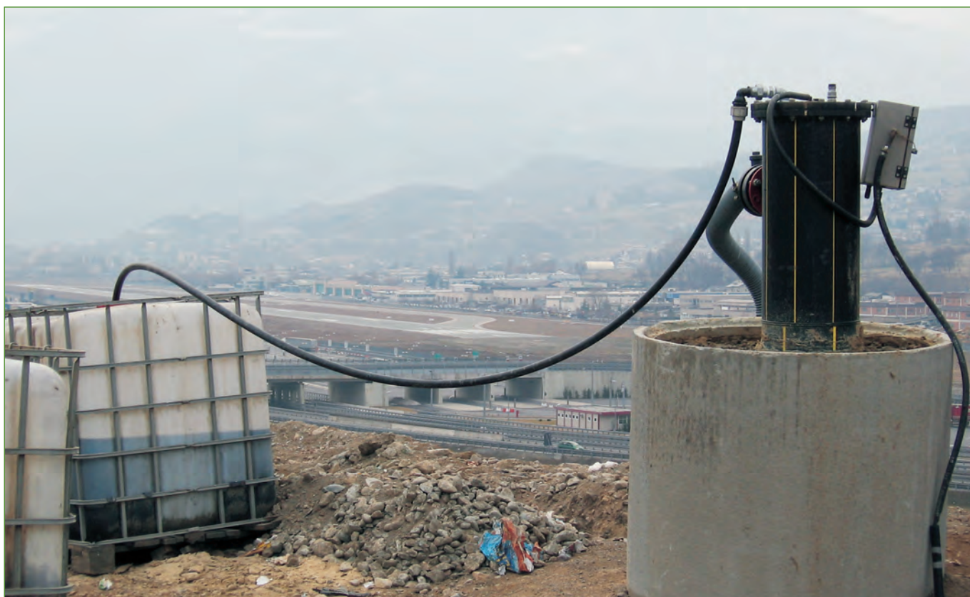
Un pozzo di estrazione del biogas
