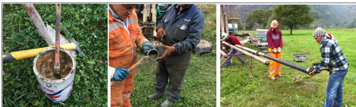
Figura 4.4 – Assemblaggio dei vari componenti (batteria di aste, carotiere e corona in widia ) e relativa lubrificazione tramite grassi vegetali (foto Borinato).
