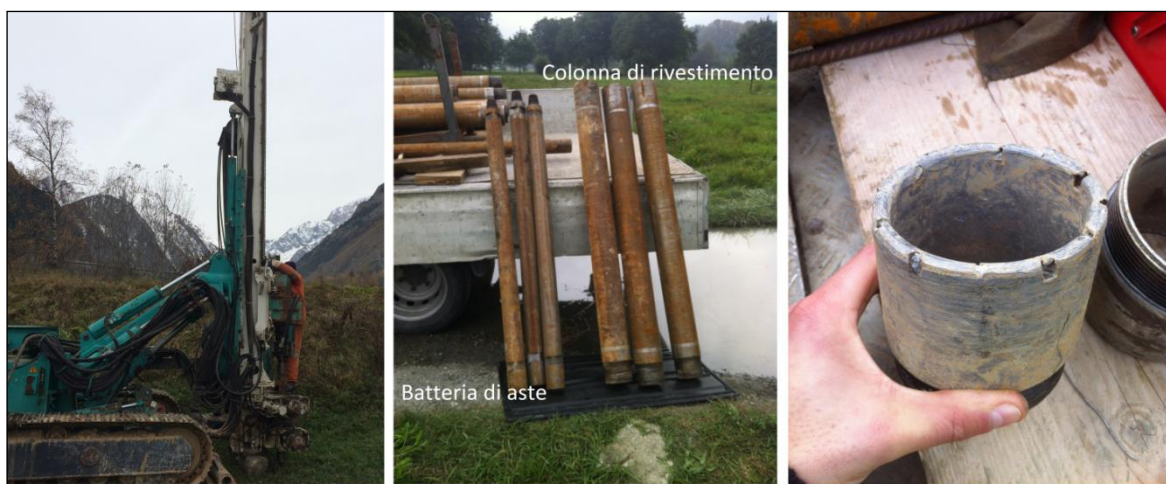
Figura 4.3 – Da sinistra: posizionamento e messa in bolla della sonda; segmenti della batteria di aste e della colonna di rivestimento; corona in widia (foto Borinato).
