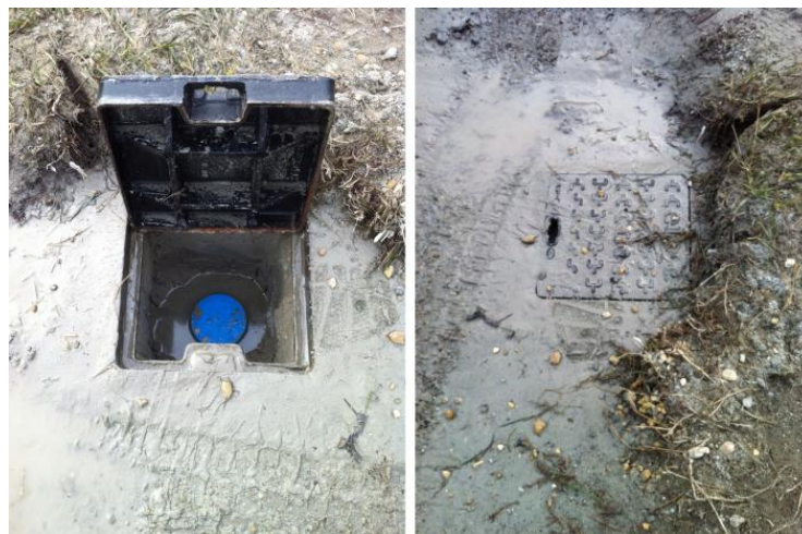
Figura 4.9 – Pozzetto e chiusino metallico a protezione del piezometro (foto Borinatto).
