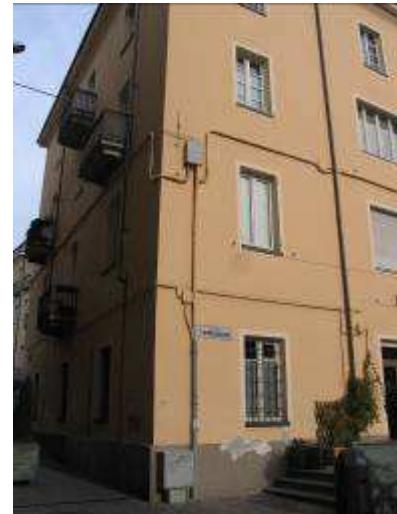
b) linee BT su facciata edificio
