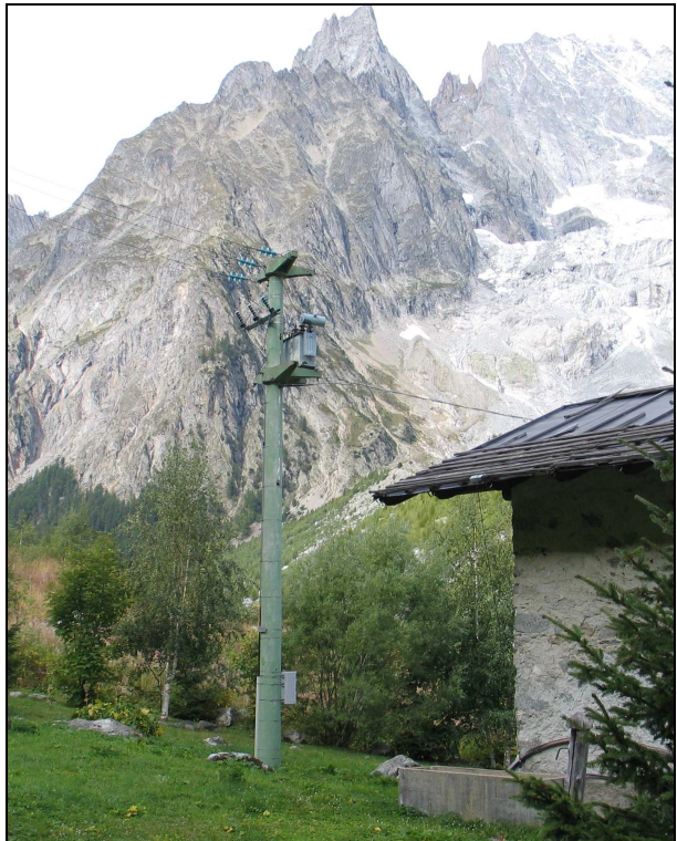
Figura 3 – Posto di trasformazione su palo.
