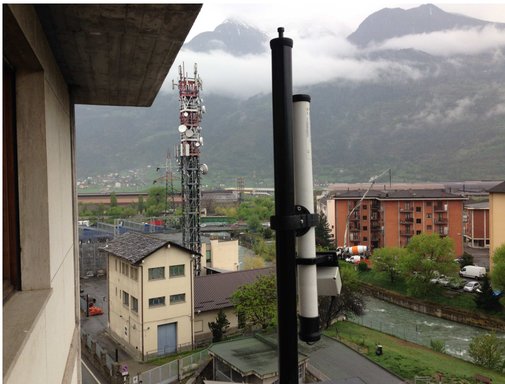
Figura 1. Centralina di monitoraggio del campo elettrico a radiofrequenza in dotazione ad ARPA VDA
